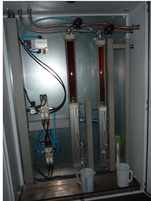
Abb 2: Binderdosierschrank mit zwei Dosierpumpen
